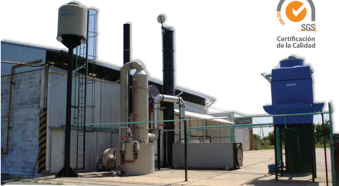
(2) Sistema de tratamiento de gases por vía húmeda con intercambiador de calor, quenche y scrubber.
